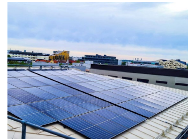
En av Uppsalas största solcellsanläggningar i Muninhuset
